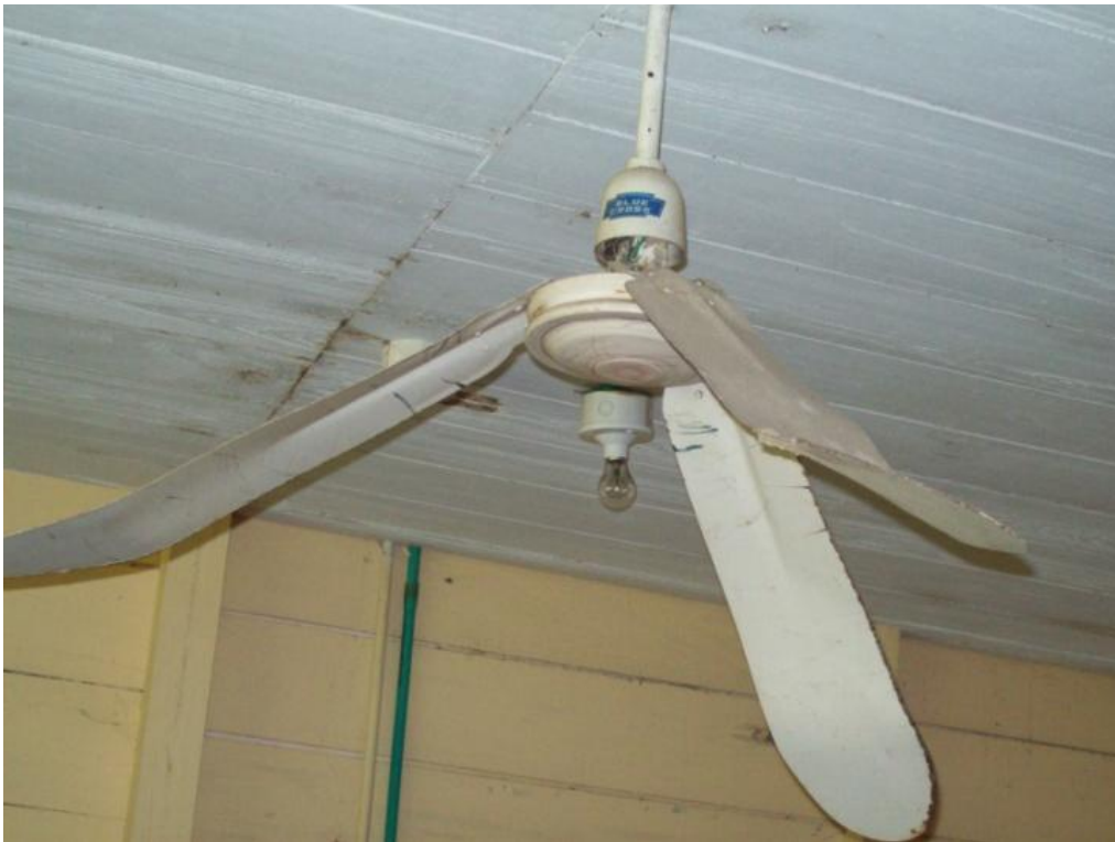
Figura 5. Desplome de objetos por mal uso.
