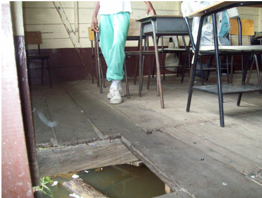
Figura 6. Piso con hueco sin sellar en salón de la escuela.
