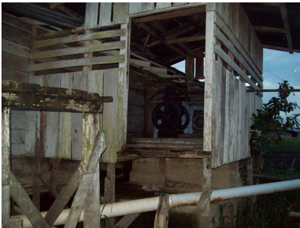
Figura 15. Planta eléctrica, a base de ACPM de la Institución educativa.
