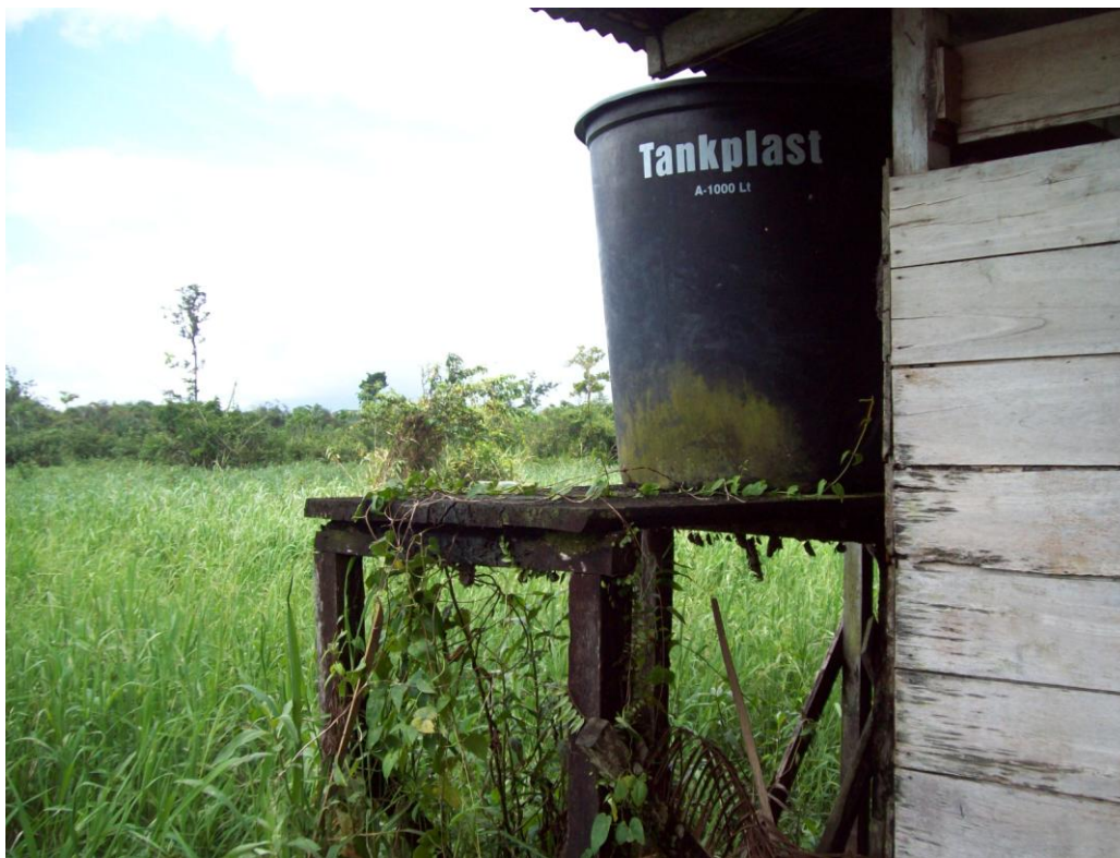
Figura 14. Suministro de aguas lluvias para sistema sanitario de la institución.
